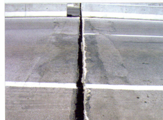
Figura 5 – Defeito em fenda de dilatação apetrechada com selante moldado no local
