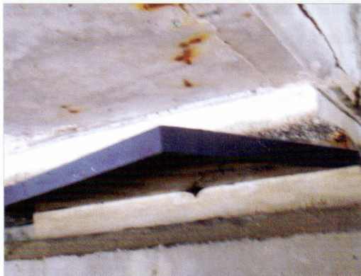
Figura 6 – Instalação errônea de aparelho de apoio, motivando expulsão da almofada do berço de assentamento
