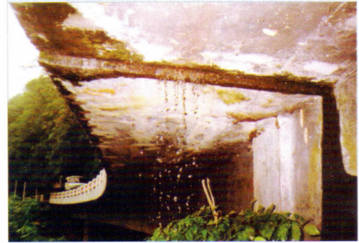
Figura 4 – Ineficácia de junta de dilatação permitindo passagem de água pluvial
