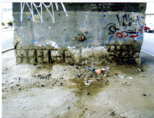
Figura 7 – Corrosão de armaduras principais de pilar
