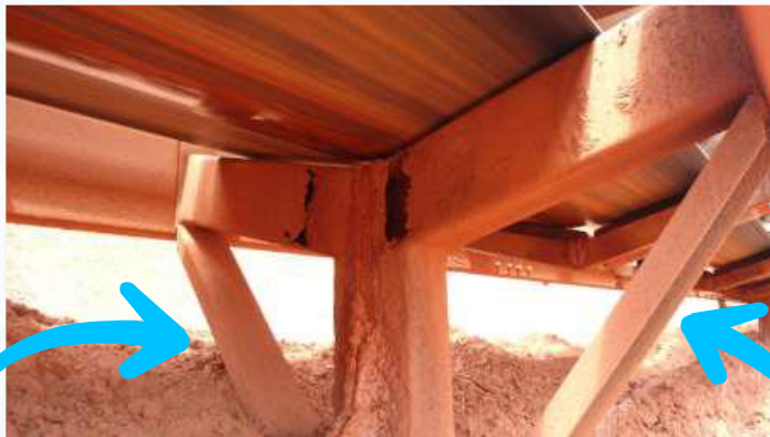
Corrosão da viga, em região tensionada, resultando em trincas. Escoramento (indicado nas setas) até substituição
