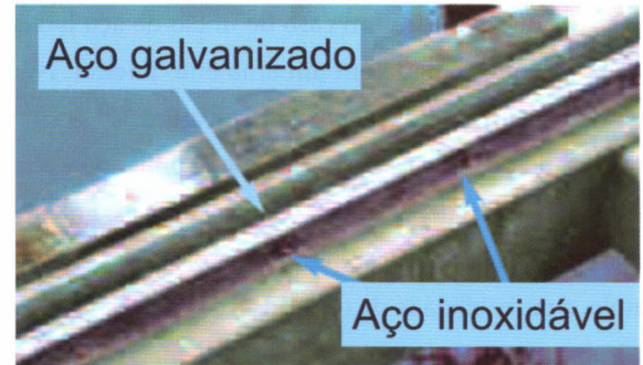
Figura 7: Parafusos de aço inoxidável conectados em componentes de aço carbono de área superficial muito maior não promovem a corrosão galvânica. Em ambos os casos, as conexões estão em ambiente externo, classificado segundo a norma ISO 9223 como C3 (ambiente de alta agressividade)
